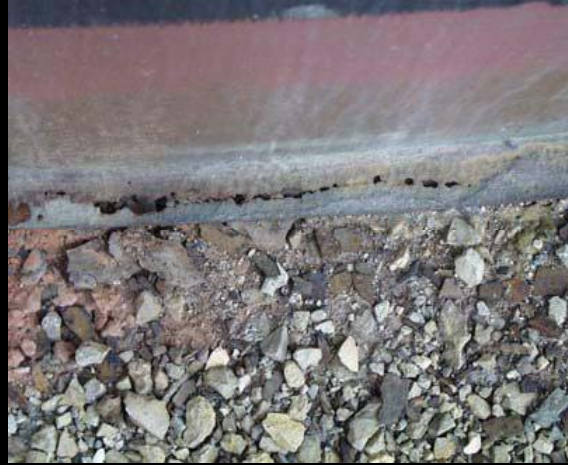
صدأ نتوء صفيحة الأرضية بسبب التآكل الجوي
